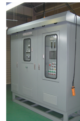
プラント設備向けの制御盤
